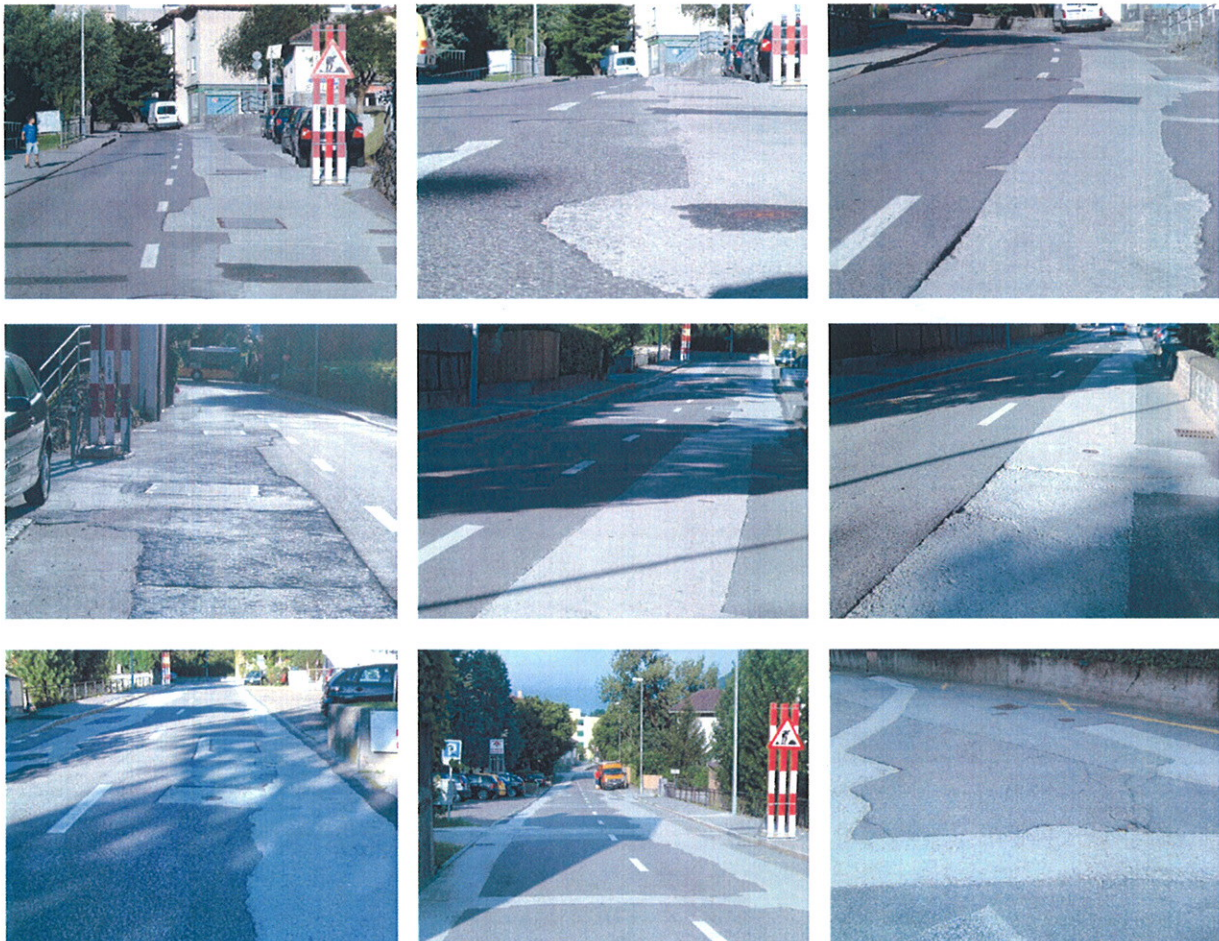
Documentazione fotografica di Via Caratti e di Via Guasta (ultima foto) al 06.08.2008
